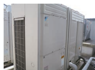
整備対象空調機
