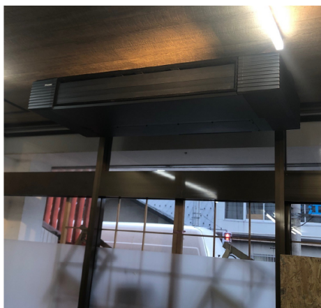
納入後（室内エアコン）
