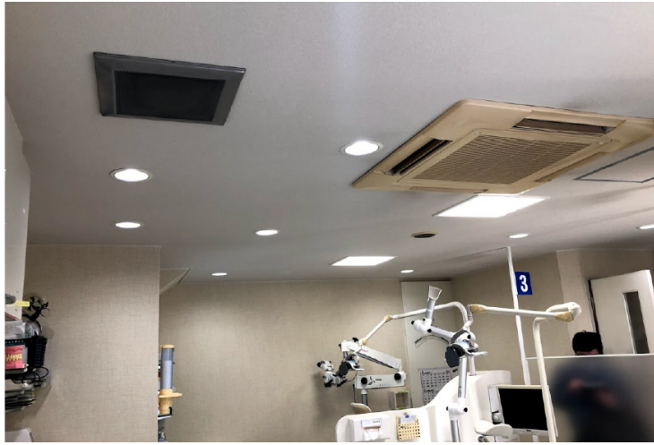
導入前の状況
