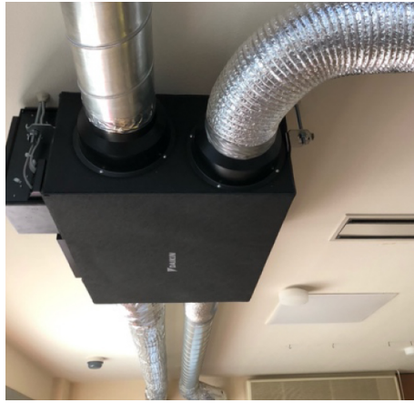
納入後写真（室内）
