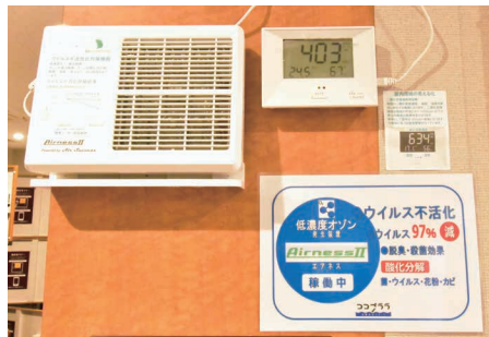
低濃度オゾン発生装置の設置
