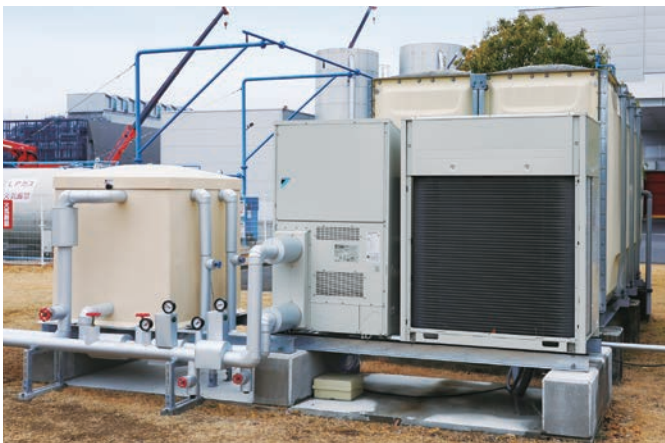
循環加温ヒートポンプ「JIZAI HEAT」
