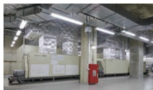
エアハンドリングユニット(既設)
