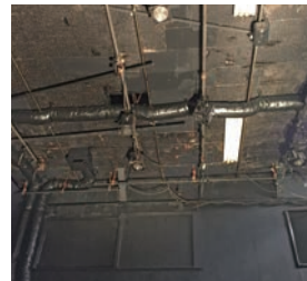
▲むき出しのダクトが換気をアピール
