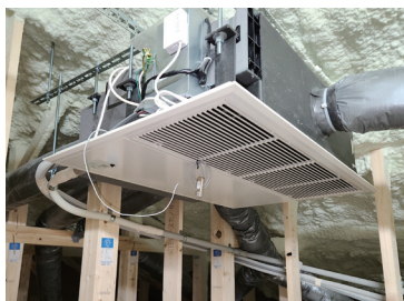
小屋裏に設置した空調機
