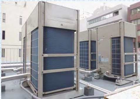
海に近いので、室外機は耐塩害仕様。
