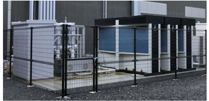
50馬力×3台のヘキサゴンモジュールチラーを近接設置して省スペースに設置
