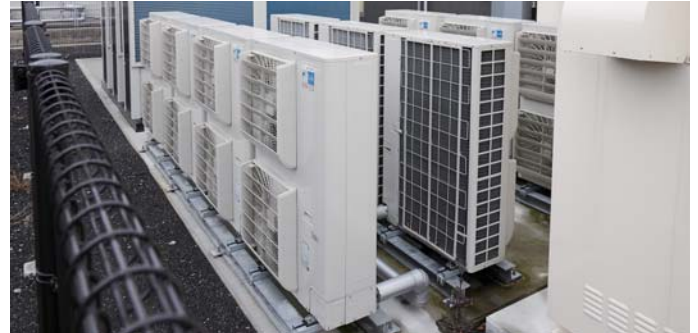
中温用インバーター-ZEASの10台の室外機もコンパクトに設置
