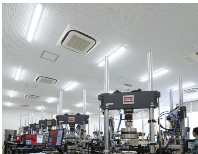
1つの疲労試験室の室温を5系統10台の中温用エアコンで年間を通して20℃に維持
