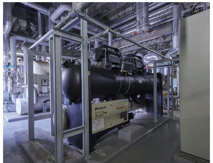
・磁気軸受ターボ冷凍機WMC300AX。動力盤レスだったので既設機後にすんなり設置。
