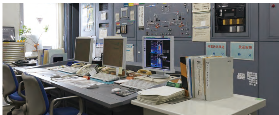
・中央監視室
