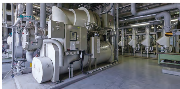
・定速機の既設ターボ冷凍機がベース負荷に対応。
