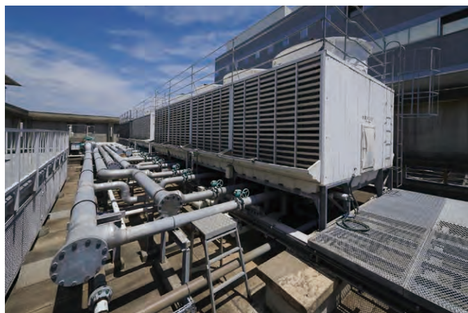
・冷却塔は既設機を再利用。
