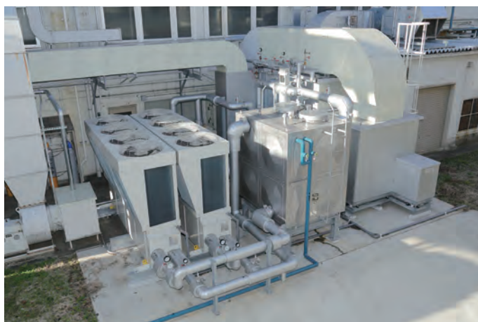
3D CADによる事前の配置検証で、クッションタンク、エアハンなど他の設備と馴染んだ整然した設置。
