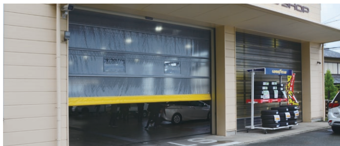
エアコンと同時に導入したシートシャッター
