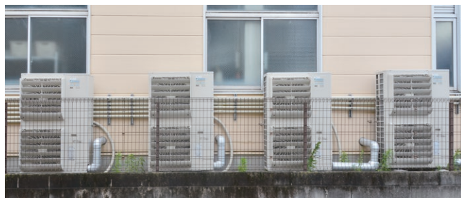
室外機には風向調整板を取り付けて通行する人にも配慮
