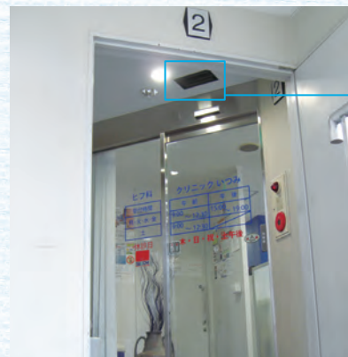
開院時間前から待ち並ぶ患者さん達のために、ドアの外側にもエアコンの吹出し口を新設
