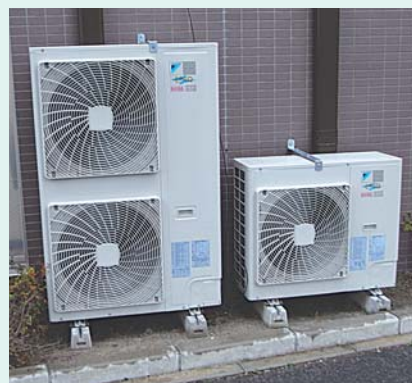
▼床面積145㎡の園内に ツイン同時運転マルチタイプ3系統を設置。
