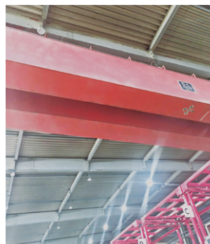
工場内の天井クレーン
