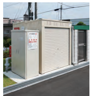
・プロパンガスを都市ガスに近いLP 13Aガスに生成する都市ガス代替設備。
