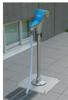
・手動ろ過装置と井戸、受水槽で飲料水も確保。マンホールトイレも装備。
