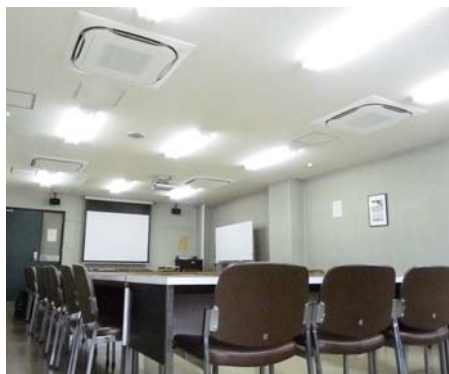
センシングフロータイプが設置された 商学部共同研究室(研究室棟)
