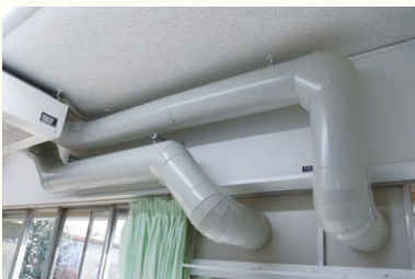
ダクトの色は壁の色に合わせた施工で、 圧迫感のない仕上がり。
