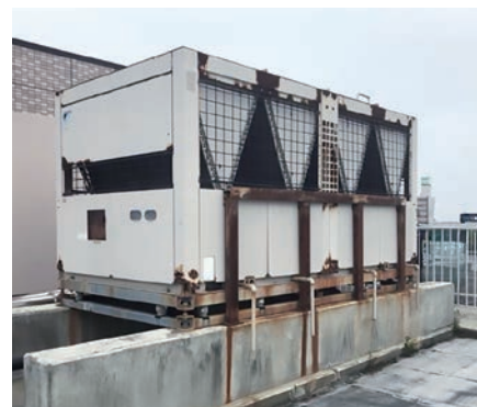
機器更新前の空冷チラー UWAJ2360A5E
