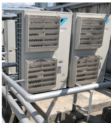
室外機は屋上にまとめて設置
