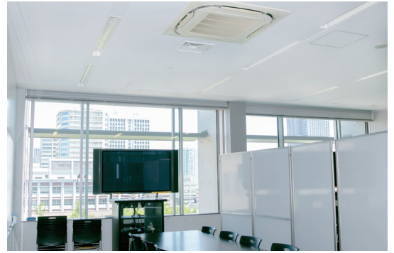
大学内の空調をまとめて管理
