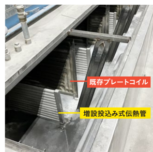
JIZAI HEAT設置後の脱脂槽内部
