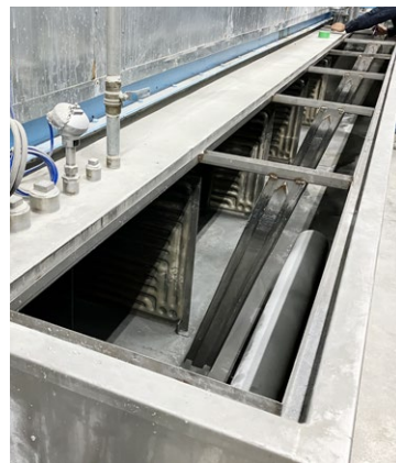
JIZAI HEAT設置前の脱脂槽内部
