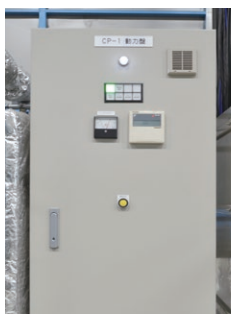
JIZAI HEAT制御盤(現地手配)
