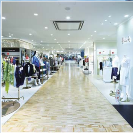
設置機器: ファンコイルユニット (大型4方吹カセット形) 設置場所: あべのハルカス近鉄本店
