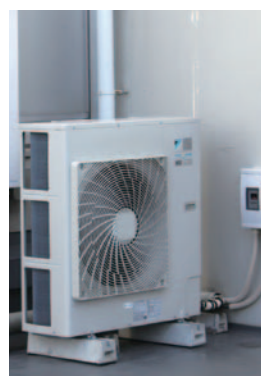
FIVE STAR ZEAS 室外機設置写真
