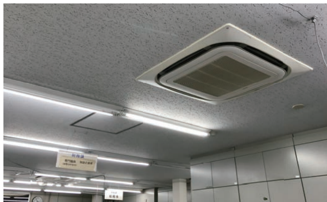
室内ユニットは既設のまま。そのため室内には工事の影響がほとんどなく、スピード居ながら更新が行えた。
