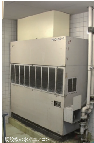
既設機の水冷エアコン
