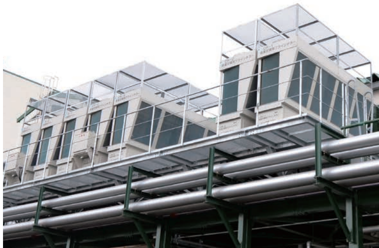
ヘキサゴンフォース32 (50馬力) 7台を、既設機の1/2スペースで設置。
