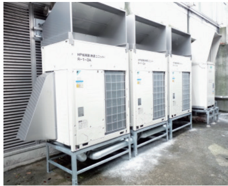
◀熱源ユニットは防寒対策として、高置台と防雪フードを設置。
