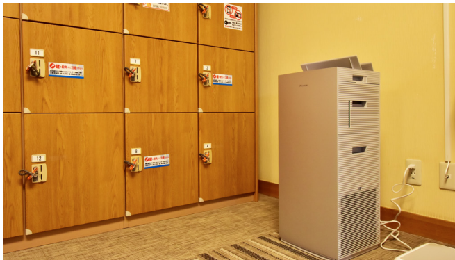
脱衣所に設置された『UV加湿ストリーマ空気清浄機』
