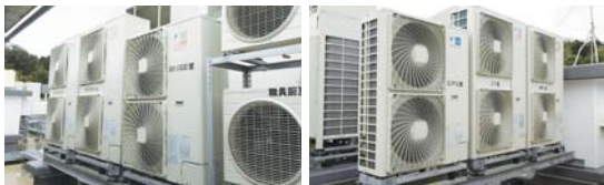
▲CPU室など重要なエリアはホッとエコZEASや中温用エアコンなど独立系統で空調。
