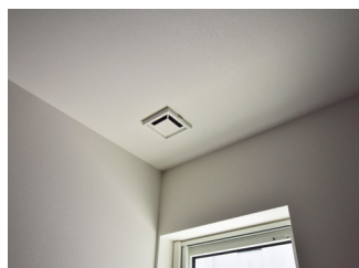
各部屋にある吹き出し口
