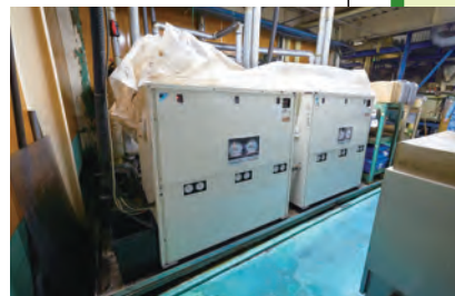
▲全ての熱源機は屋外のばい煙などの影響を避けて屋内設置に(平野工場)。
