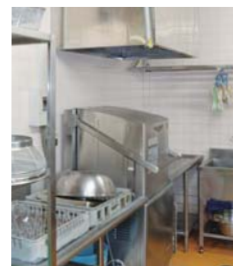
▲食器洗浄機をはじめ、 厨房は全て電化機器に。
