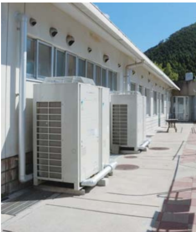
▲個別空調方式のホッとエコビルマルで 運転のムダを抑える事ができました。
