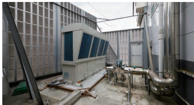
2台の水冷チラーとクーリングタワーが撤去され機器スペースは大幅に縮小。
