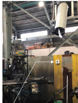
リモコンを室内機のそばに1台ずつ 設置し、各自で調節
