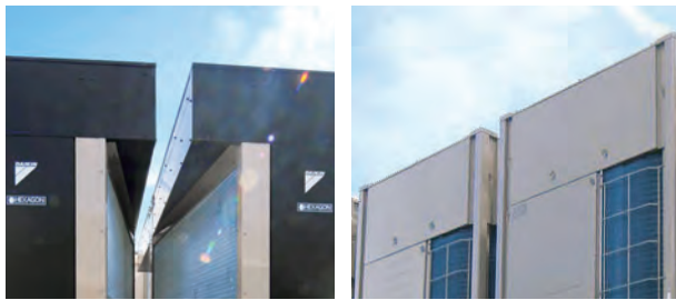
近接設置された2台のヘキサゴンモジュールチラー 近接設置された2台のVe-upモジュールチラー
