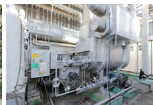
30年間稼働していた ガス吸収式冷水発生機。
