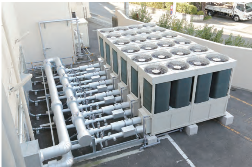
ヘキサゴンフォース32(60馬力)6台・合計360馬力システムを限られたスペースに設置。
