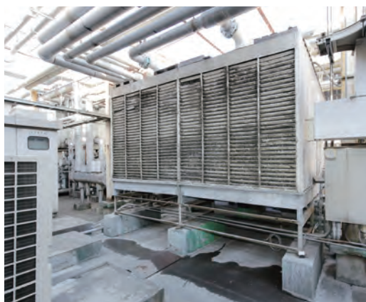
冬場は冷却塔(既設機)のみで冷却水を自然冷却。
