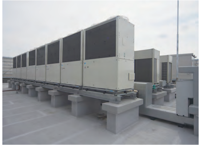
・GHP室外ユニットは全て都市ガス/臭気低減仕様機。
