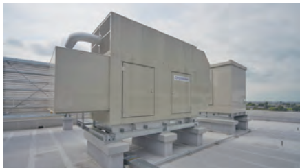
・停電時に医療機器や照明、最小限の空調用電源を確保する自家発電設備。
