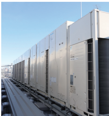
室外機は屋上にまとめて設置
