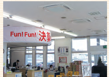
1階の接客スペースには、センシング機能のついたS-ラウンドフローを設置。
