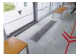
アンダーフロア(防災センター)
