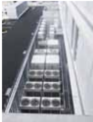
手前から ・ビル用マルチ室外機 ・氷蓄熱ビル用マルチ ・業務用エコキュート
