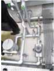
給湯配管周り
