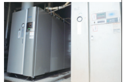
▲ 左がMEGA・Qと組合せた新設の蒸気ボイラー、右は既設(点検中)の蒸気ボイラー。沿岸地域にあるため外装に亜鉛メッキを施した。転倒防止の厳重なワイヤーも台風対策。
