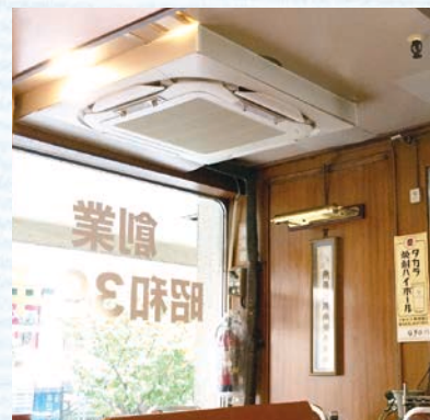
ラウンドフローに入替え、熱気のごもっていた入口側にも風が行き渡り快適に。
