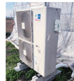
側面にIoT端末が設置された室外機。
